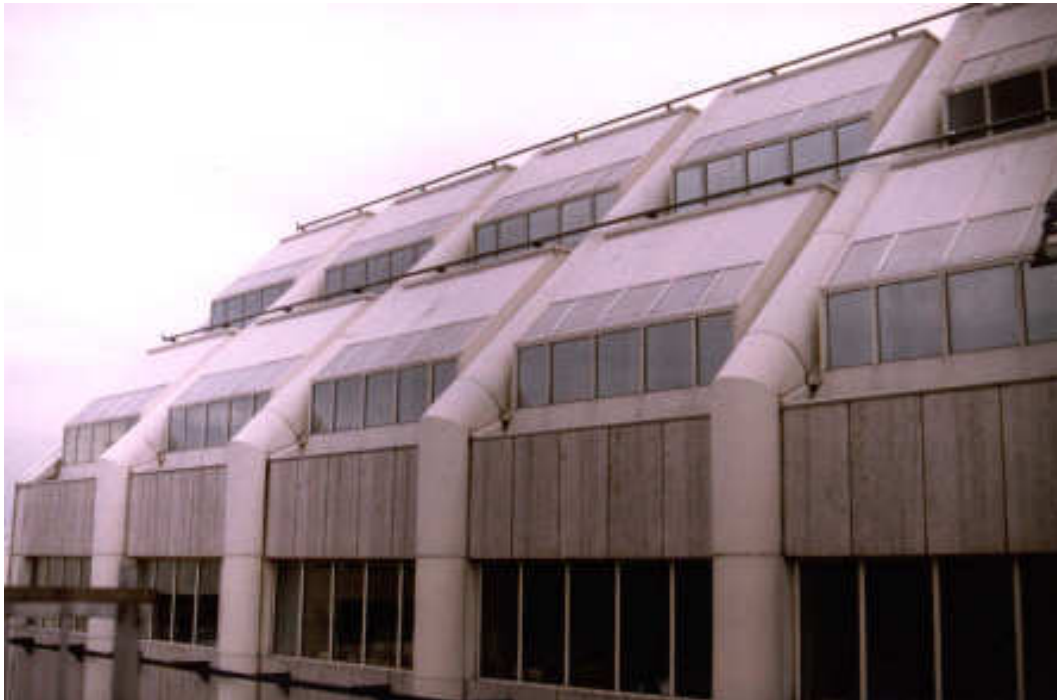
Foto 3. Een vervuilde gevel: Wel of geen reden voor onderhoud?
